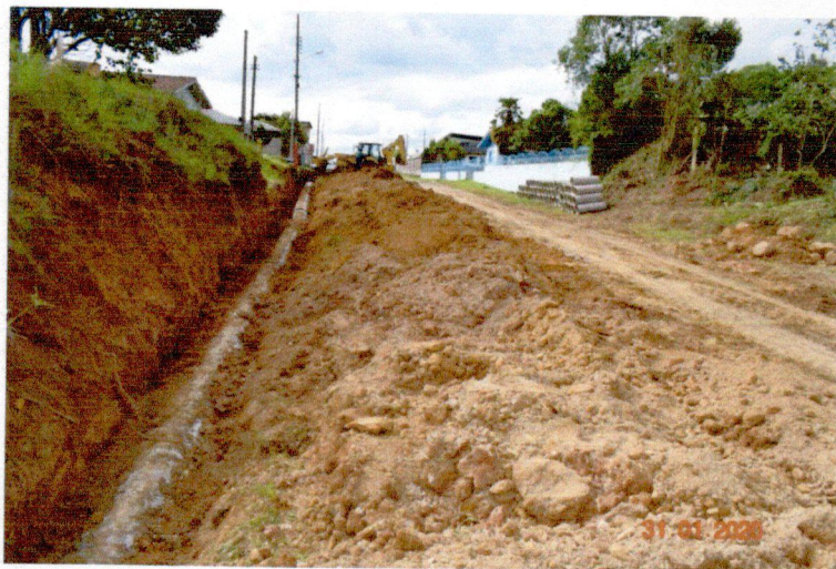
Figura 1 - Execução das tubulações, aterro sem compactação.
