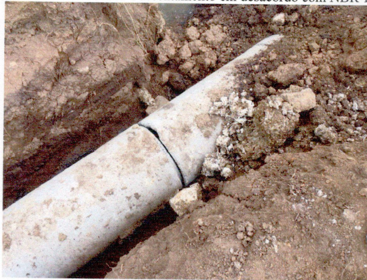
Figura 5 - Tubo danificado e assentamento em desacordo com NBR 15645.
